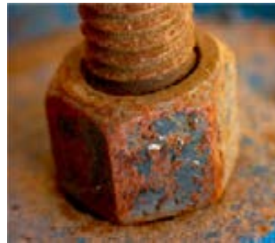
Đinh ốc bị rỉ sau một thời gian để ngoài không khí
